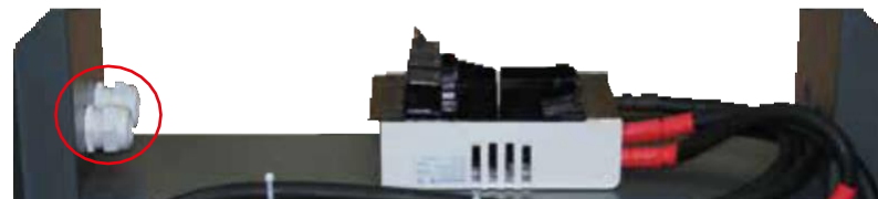
Obrázek 8: Horní úroveň nosiče s kabelovými průchodkami
