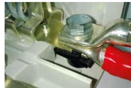
Obrázek 5: Kabelová oka jsou otočena proti sobě
